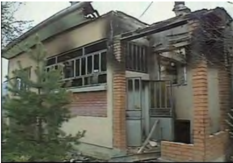
ZAPALJENA KUĆA DŽEMALA (HUSO) AHMIĆA
