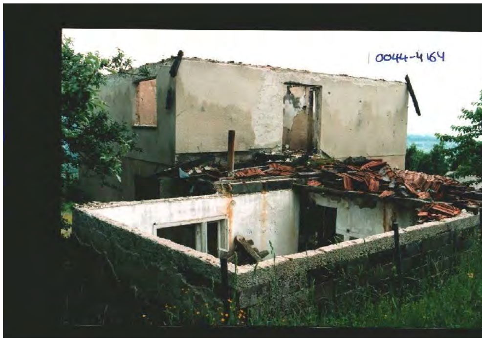
IZGORJELA KUĆA HADŽE BILIĆA U PIRIĆIMA
