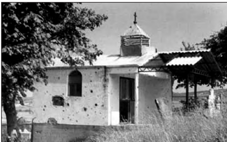
Oštećena grobljanska kapelica u Golubiću
