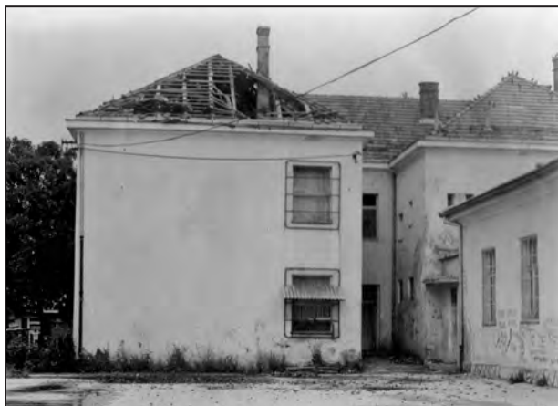
Oštećena zgrada Medicinske škole u Bihaću
