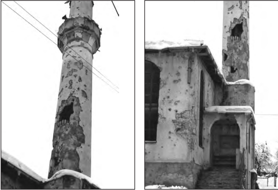
Oštećena džamija na Vinici
